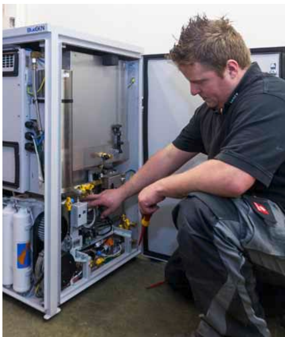
Heizungsbauer Holger Hötz von der Firma Hohnen weiß, wie man eine Brennstoffzelle installiert.
